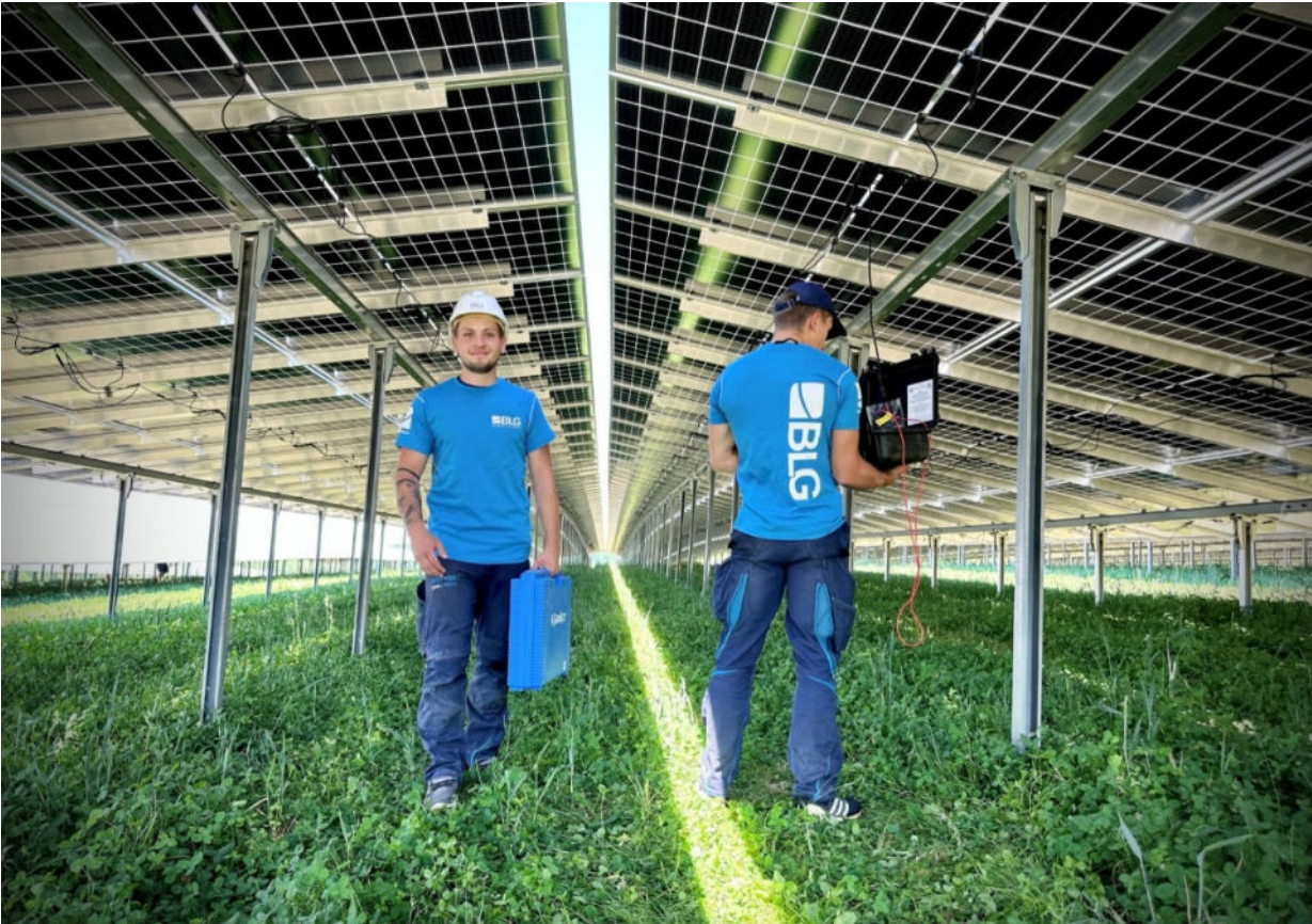
Abb. 4: Solarpark mit bifazialen Modulen
